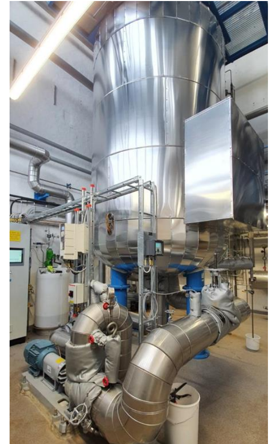
E-boiler bij Avebe in Malmö
